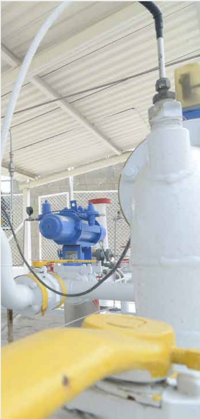
Estación de Regulación Bavaria (Santa Marta)
