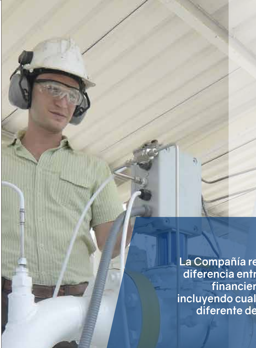
Estación de Regulación Bavaria (Santa Marta)
